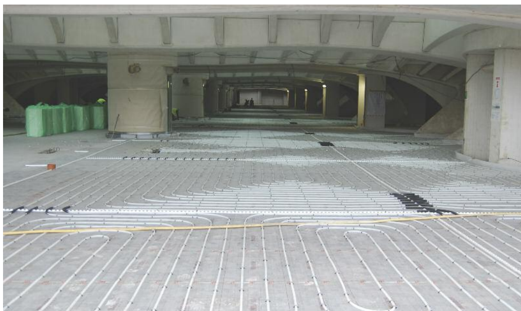
Le système de chauffage par le sol de Radson dessert les 3300 m 2 de surface brute (2700 m 2 de plancher chauffant) de la zone d'accès aux quais de la gare de Liège-Guillemins.
